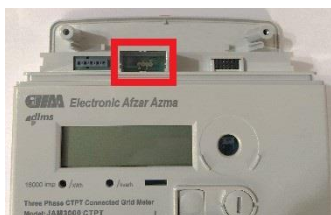
محل نصب باتری خارجی (بعد از پانچ)
