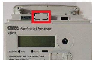
محل نصب باتری خارجی (قبل از پانچ)
